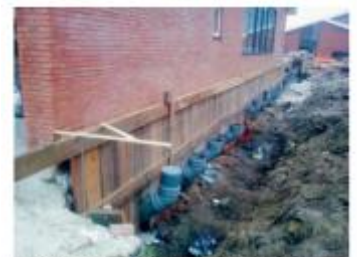
In de brede school De Meerkant in Midwolda wordt de lucht via een lucht-bodemwisselaar (L.B.W.) aangezogen. Hierdoor wordt ventilatielucht voorverwarmd of gekoeld. De leidingen hiervoor liggen circa 2 meter onder het maaiveld, architect: Gunstra Architecten - Bolsward, adviseur: Sijperda - Hardy IJst, opgeleverd: 2011.
