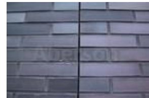
Figuur 1 Dilatatievoeg in metselwerk
