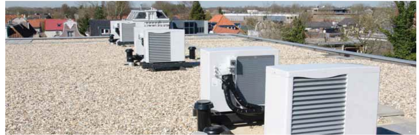
In de praktijk wordt bij warmtepompen regelmatig te hoge geluidproductie vastgesteld. Niet alleen ten gevolge van de buitenunit, maar ook in de woning door ruis in de leidingen.
