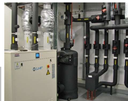
cv-ketels stadsverwarming warmtepomp
