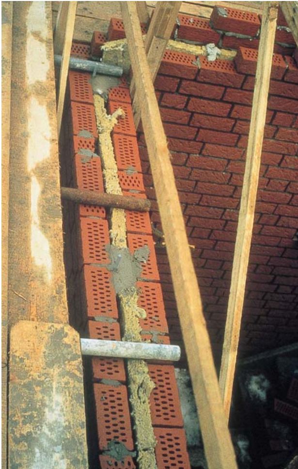
figuur 8. niet direct de meest geschikte wijze om isolatiemateriaal op zijn plaats te houden!
