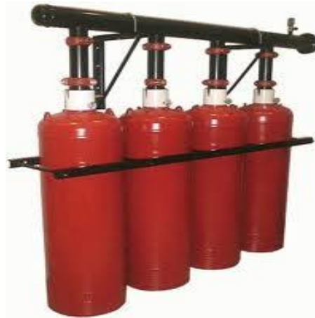
Figuur 4: Centrale blusgas opstelling.
