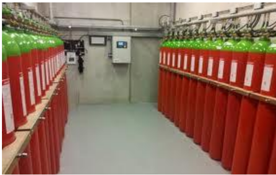
Figuur 5: Cilinderbatterijen met verzamelleidingen.
