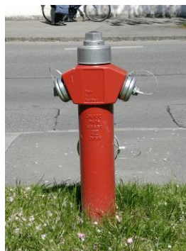
Figuur 28: Bovengrondse hydrant
