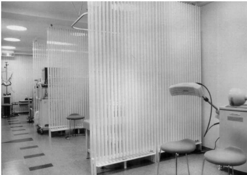
figuur 3 ruimtescheidende koelradiatoren
