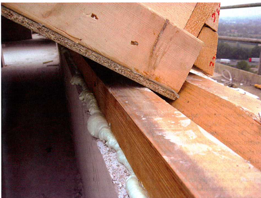
Zorg voor een goede luchtdichting tussen dakplaat en kantgording (muurplaat). Hier ontbreekt deze. Er is wel een dichting aangebracht tussen muurplaat en de betonconstructie. Foto: Adviesburo Nieman.
