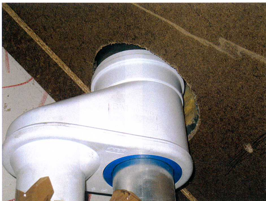
FOUT: doorvoer is niet voorzien van een afdekplaat/dichting. Hier is een groot luchtlek aanwezig. Foto: Adviesburo Nieman.
