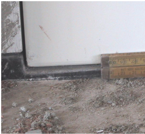
Aan de binnenzijde van de woning tussen de bovenzijde van de onderdorpel en de dekvloer is slechts een hoogteverschil van circa 1 cm aanwezig. Hoewel dit hoogteverschil volgens het Bouwbesluit correct is, ontstaan er vanuit praktisch oogpunt, afhankelijk van de toe te passen vloerafwerking, mogelijk knelpunten.
