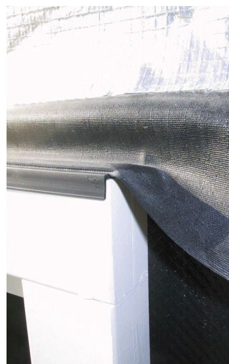
De bovendorpel is niet afgeschuind waardoor deze het hemelwater niet afvoert.
