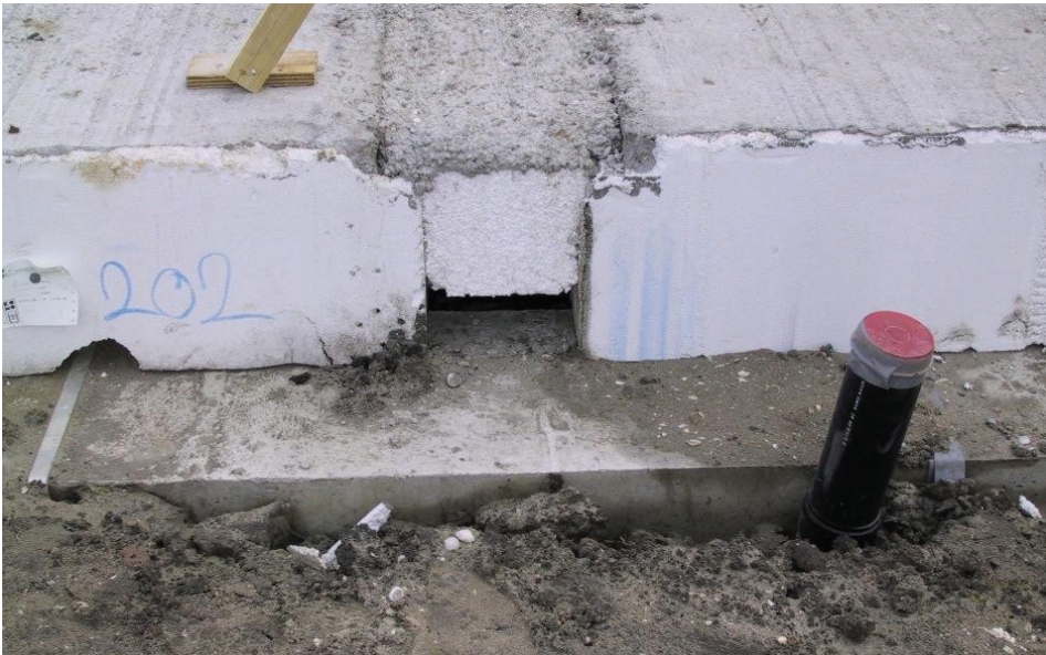
De ruimte onder de passtrook is niet afgedicht, waardoor de kruipruimte in open verbinding staat met de luchtsponw. Hierdoor kan vochtige lucht in de woning komen.
