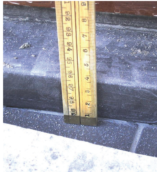
De opstand van de onderdorpel van de toegangsdeur is aan de buitenzijde groter dan 20 mm (circa 35 mm) en voldoet daardoor niet aan het Bouwbesluit. Een mogelijke oplossing is het verhogen van het straatwerk.
