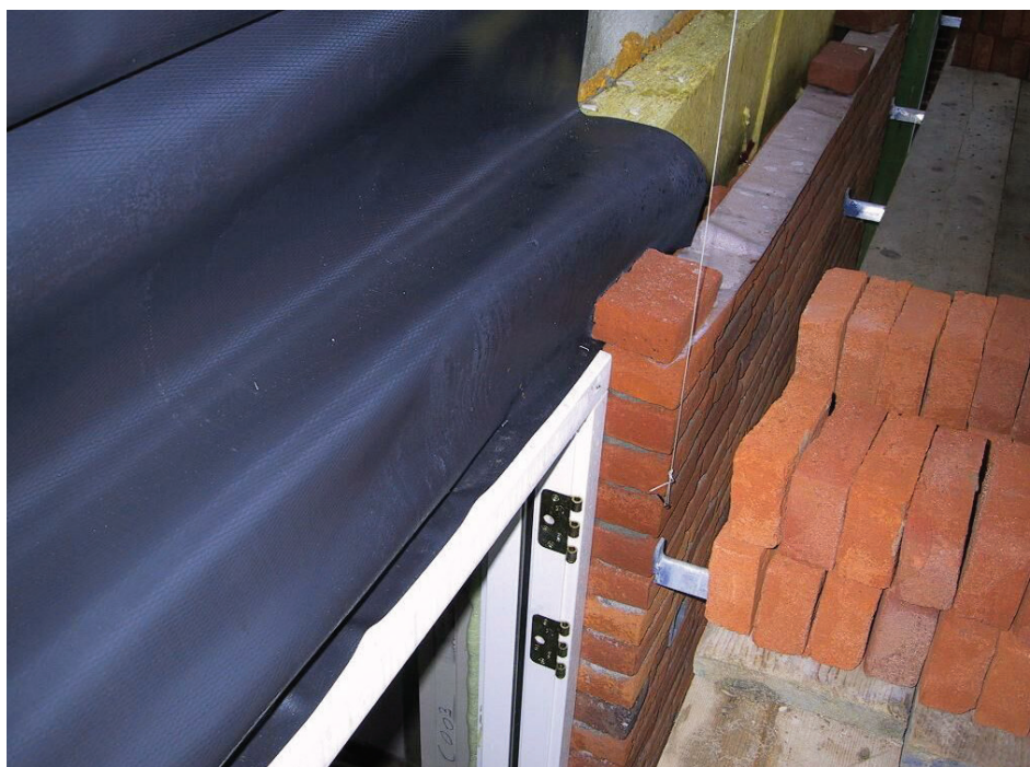
Geen ondersteuning van de waterdichte laag door middel van afgeschuinde EPS of minerale wol. Hierdoor kan er een gootje ontstaan.
