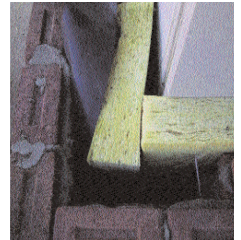
4) Achter het isolatiemateriaal ontstaat een luchtlaag als bij de hoek het isolatiemateriaal niet goed is afgesneden.
