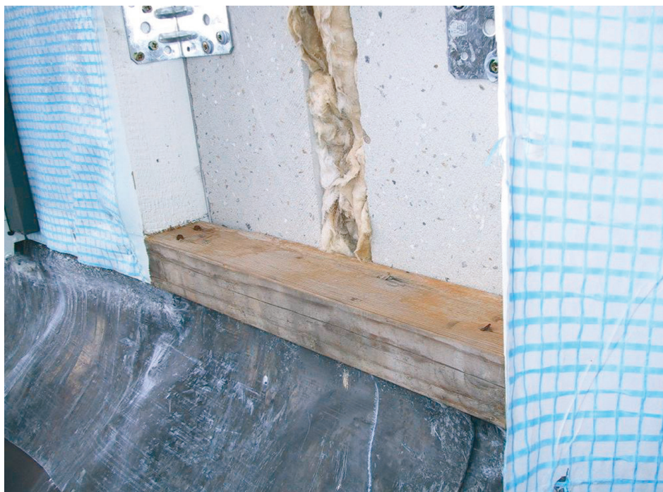
Het regelwerk ten behoeve van het plaatmateriaal is ter plaatse van de bouwmuur niet ontkoppeld.
