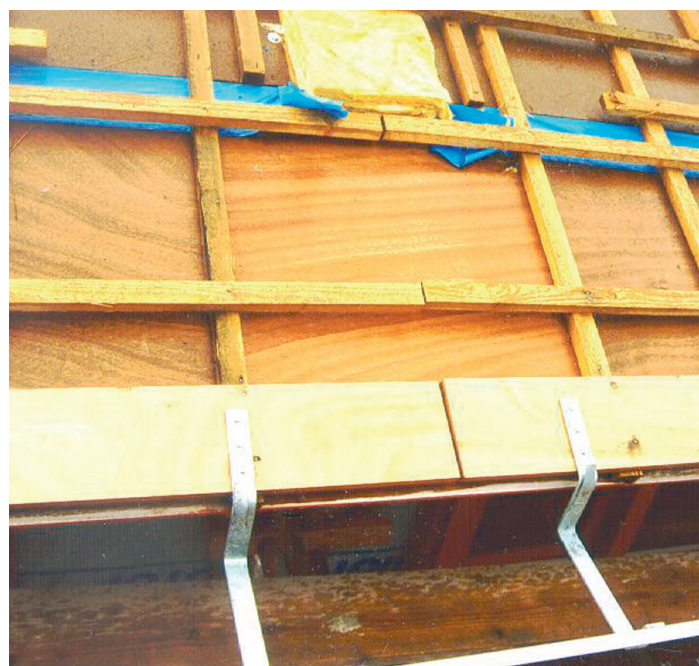
Dilatatie bij vervangend dakbeschot vergeten, waardoor een koppeling ontstaat (bovenaanzicht).
