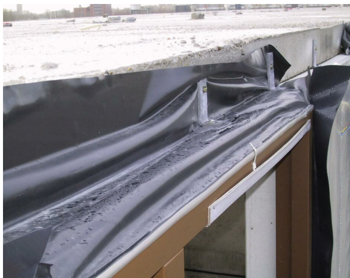
Ankers doorbreken de waterdichte laag; hierdoor is het folie niet meer waterdicht. Ook de bovendorpel van het kozijn is niet afgeschuind.
