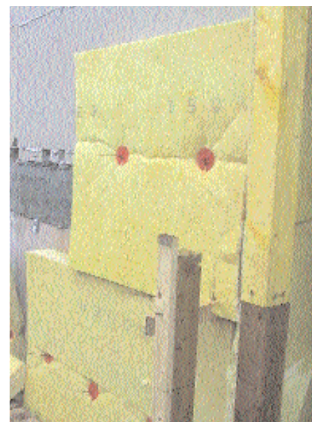
5) Vastzetten met te weinig spouwankers betekent dat de isolatieplaten onderling niet goed op elkaar aansluiten. Daarnaast is de passtrook niet met minimaal twee spouwankers vastgezet.
