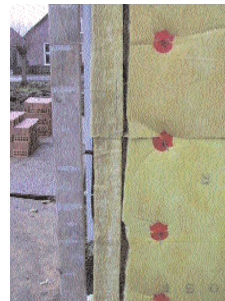
6) Ter plaatse van de hoek is de aansluiting van de platen onderling niet goed afgesneden of dichtgebonden waardoor de plaatnaden niet goed aansluiten.
