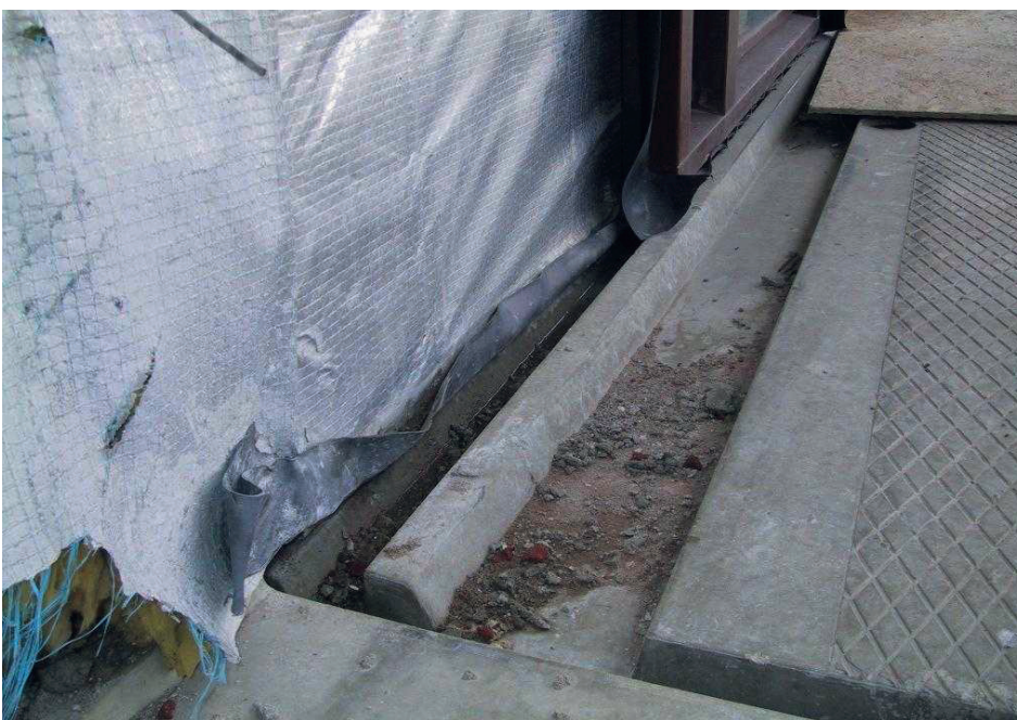
De eindplaat heeft geen kopschot. Het hemelwater zal niet via de geconstrueerde wegen lopen.
