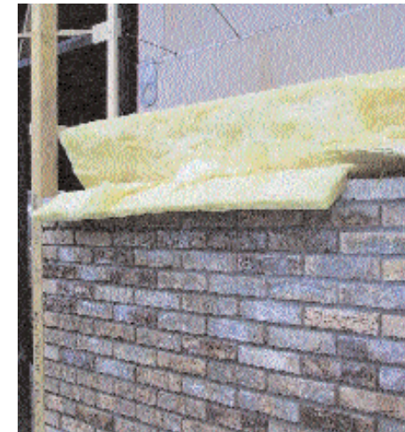
3) Niet afdekken van het metselwerk tijdens de uitvoering heeft tot gevolg dat aantasting van het isolatiemateriaal plaatsvindt door weersinvloeden (regen en wind).
