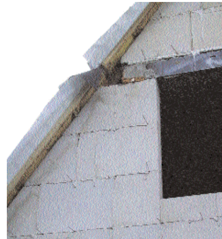
2) Tijdens het lijmen van het kalkzandsteen zijn de lijmbaarden aan de buitenzijde van het binnenspouwblad niet verwijderd.
