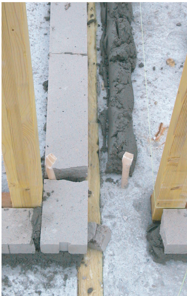
Isolatie is onvoldoende hoog aangebracht.
