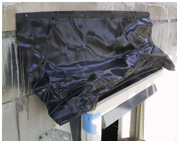
De waterdichte laag is slordig aangebracht, waardoor er gootjes kunnen ontstaan.
