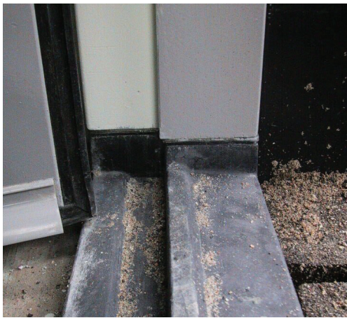
Door de winddruk op de gevel kan vuil in de afwateringsgoot van de onderdorpel terecht komen. Gevolg: verhinderend van de afvoer van hemelwater. De toepassing van het juiste type onderdorpel kan dit probleem verhelpen.
