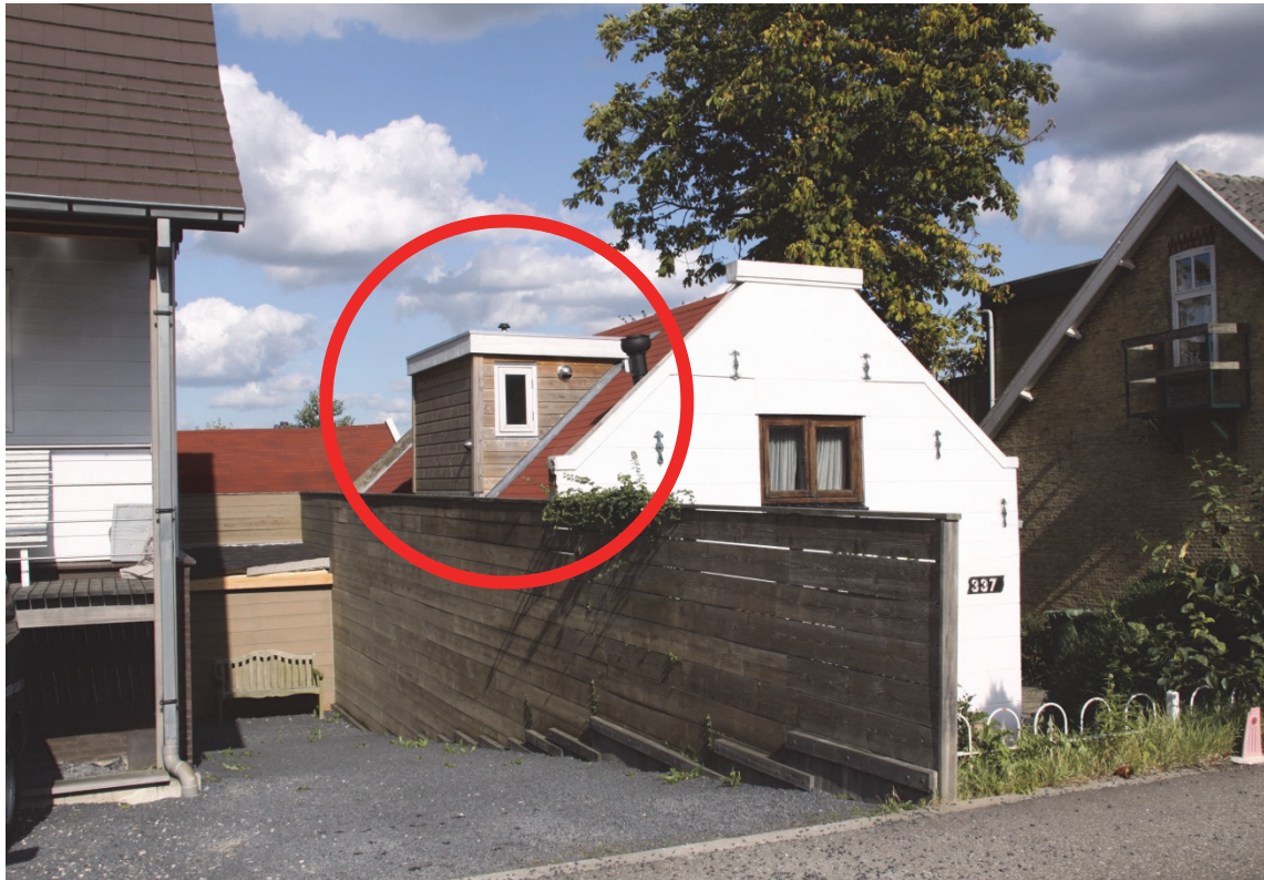
Figuur 2-2 In de dakkapel mag geen raamopening worden aangebracht, de dakkapel grenst immers direct aan een ander perceel. Het aanbrengen van “mat glas” was wel mogelijk geweest.
