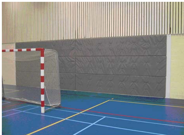
Figuur 4.21. In enkele hallen van het sportcentrum van de TU/e zijn geluidabsorberende 'deken's' (zachte vulling in 'geperforeerde hoezen') aangebracht ter onderdrukking van flutterecho's, veroorzaakt door lucht- en contactgeluid (bal tegen muur).
