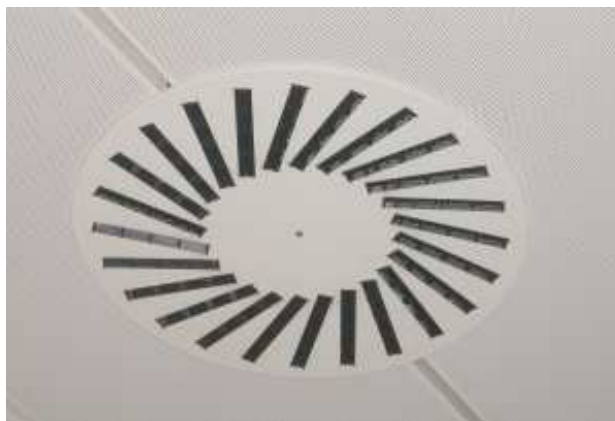
Figuur 1.11. Geluidbron met een lage Q ( Q \approx 2 , inblaasrooster t.b.v. luchtbehandeling in de collegezalen van het Auditorium TU/e).
