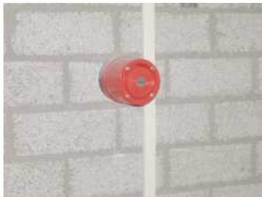
Figuur 1.3. Ontruimingsalarm: bolbron op hard vlak.
