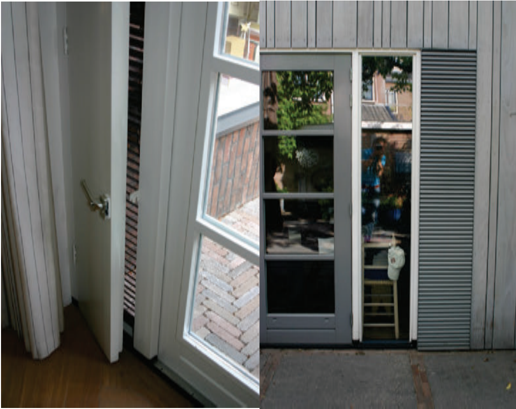
Afb. 6.23 Voorbeeld van een voorziening voor zomernachtkoeling in een woning te Zeist. In de gevel van de woonkamer zijn 2 inbraakvrije ventilatieroosters ( 2 \times 0,25 \times 2 \text{ m} = 1 \text{ m}^2 ) met een isolatieluik aangebracht; een dakraam zorgt voor een goede natuurlijke trek. (Betrokken partijen: Architect ii studio, realisatie Ettekoven Aannemer & interieurbouwer, advies BOOM-SI; realisatie 2009. Foto's: Joost Ettekoven)
