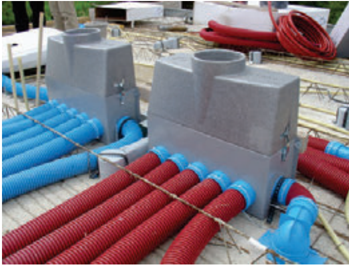
Afb. 6.4 Twee luchtverdeelkasten bij een gebalanceerd ventilatiesysteem, de ene voor de toevoerlucht (met de blauwe kanalen), de andere voor de afvoerlucht (met de rode kanalen). In de verdeelkast worden de luchthoeveelheden ingeregeld. Dit heeft als voordeel dat men niet-regelbare ventielen voor toe- en afvoer gebruikt die dus niet onregelmatig kunnen worden bij bijv. het schoonmaken door bewoners. In de verdeelkasten, die deels in de (beton)vloer aangebracht zijn, kunnen geluiddempers worden ingebouwd. De verdeelkasten moeten bereikbaar blijven voor inspectie en onderhoud. (Bron: Burgerhout BV)
