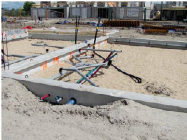
Afb. 7.22 Rechts op de voorgrond, tussen de funderingsbalken, is de aansluiting (zie de twee zwarte leidingen) met de verticale bodemwisselaar te zien. De foto is genomen in RijswijkBuiten in Rijswijk (ZH)
