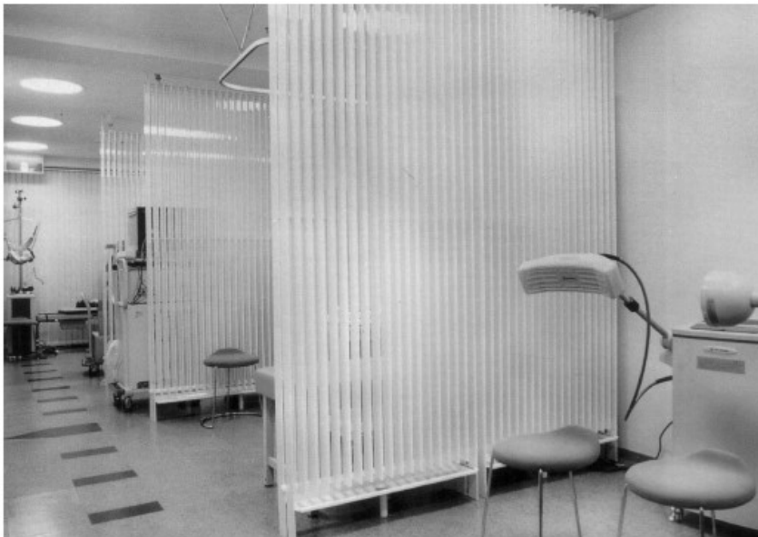
figuur 4 ruimtescheidende koelradiatoren
