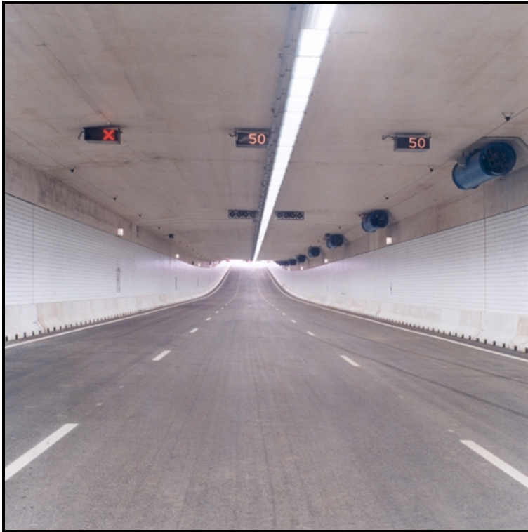
figuur 9. stuwkrachtventilatoren voor de langsventilatie van een tunnelbuis
