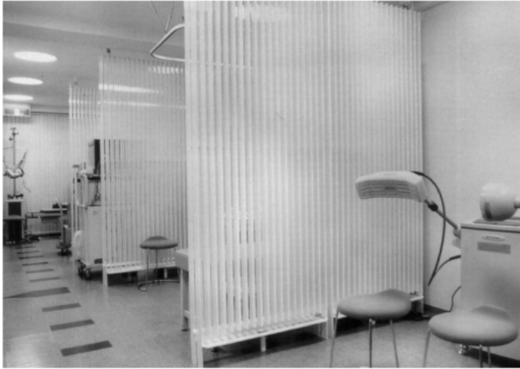
figuur 5. ruimtescheidende koelconvectoren
