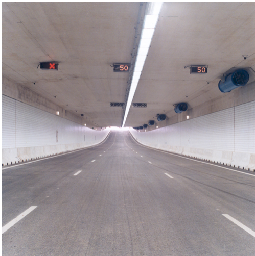
figuur 5. stuwkrachtventilatoren in een tunnel
