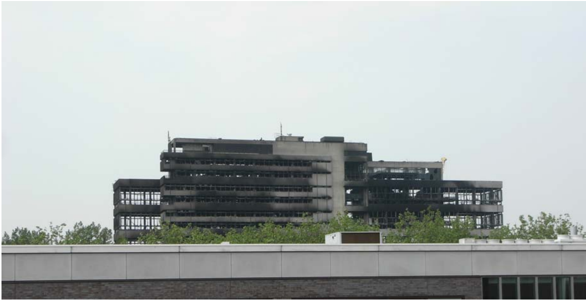
Figuur 1. Gebouw faculteit Bouwkunde TU Delft, direct na de brand
